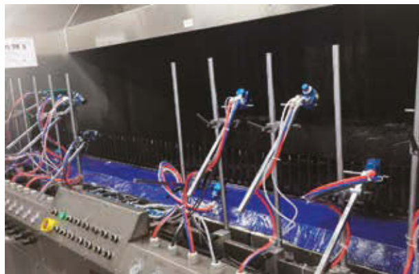
Automatic painting line 自動噴油線
